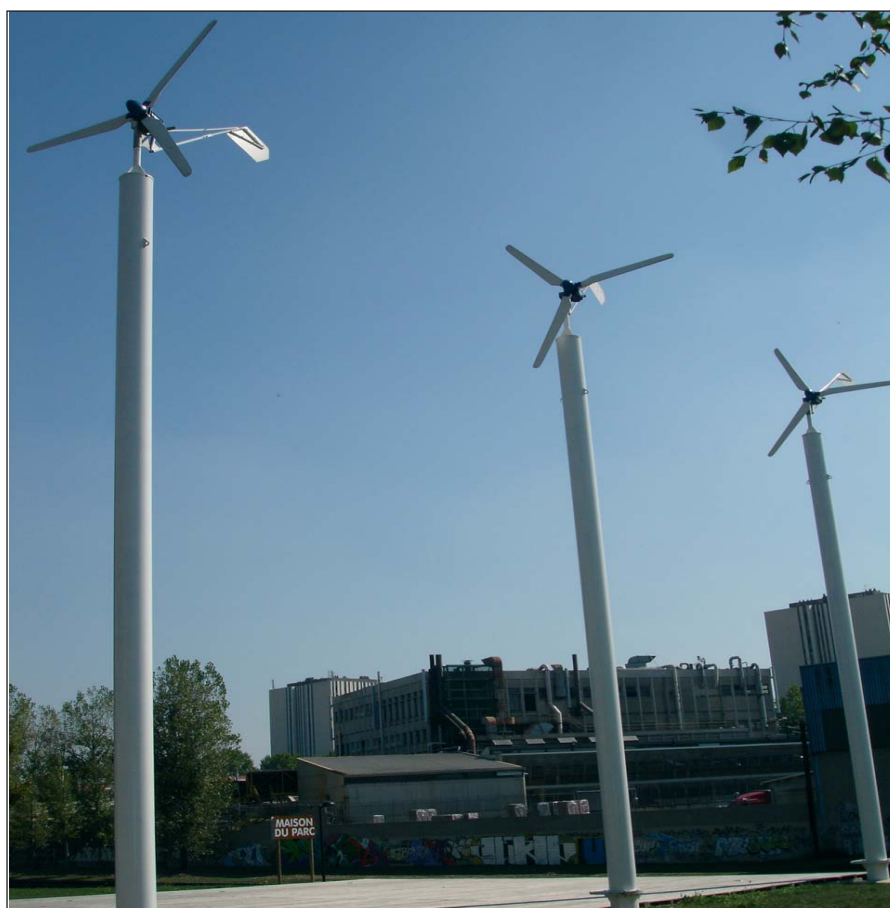
Éoliennes (chacune de 6 kW) de la maison d'accueil de Bobigny (93).
