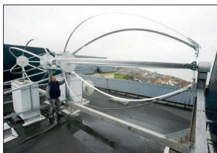
Les deux rotors longs de 5 m entraînent une génératrice de 6 kW placée au milieu des rotors qui produit 7 à 8 000 kWh/an.
